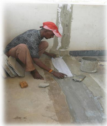
Installation de panneaux électriques et imperméabilisation des murs de l'hôpital grâce au financement et aux devis techniques de bailleurs de fonds spécialisés dans le domaine.
